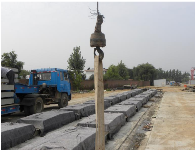
吊钩均使用保险销
